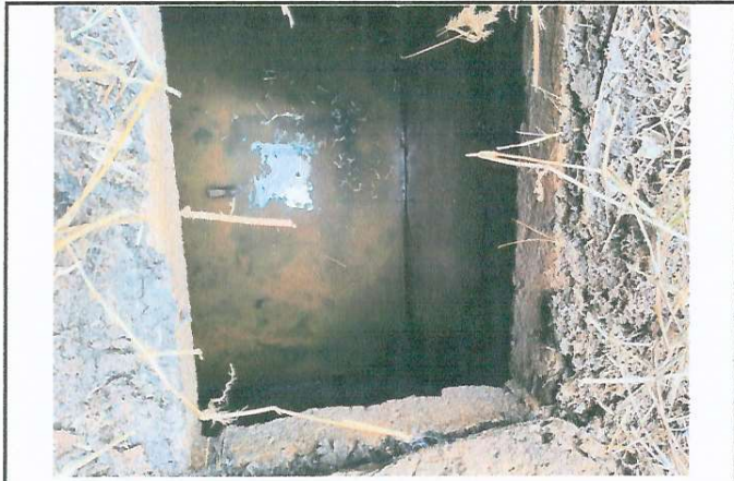
Foto 3: Red de Drenaje
